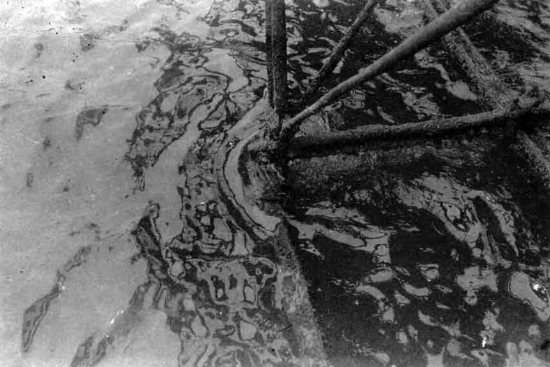
Fig. 4. Impacto del "Fenómeno El Niño" en los pilares del muelle Zorritos. Foto: G. Petersen G., 30. 3. 1948
