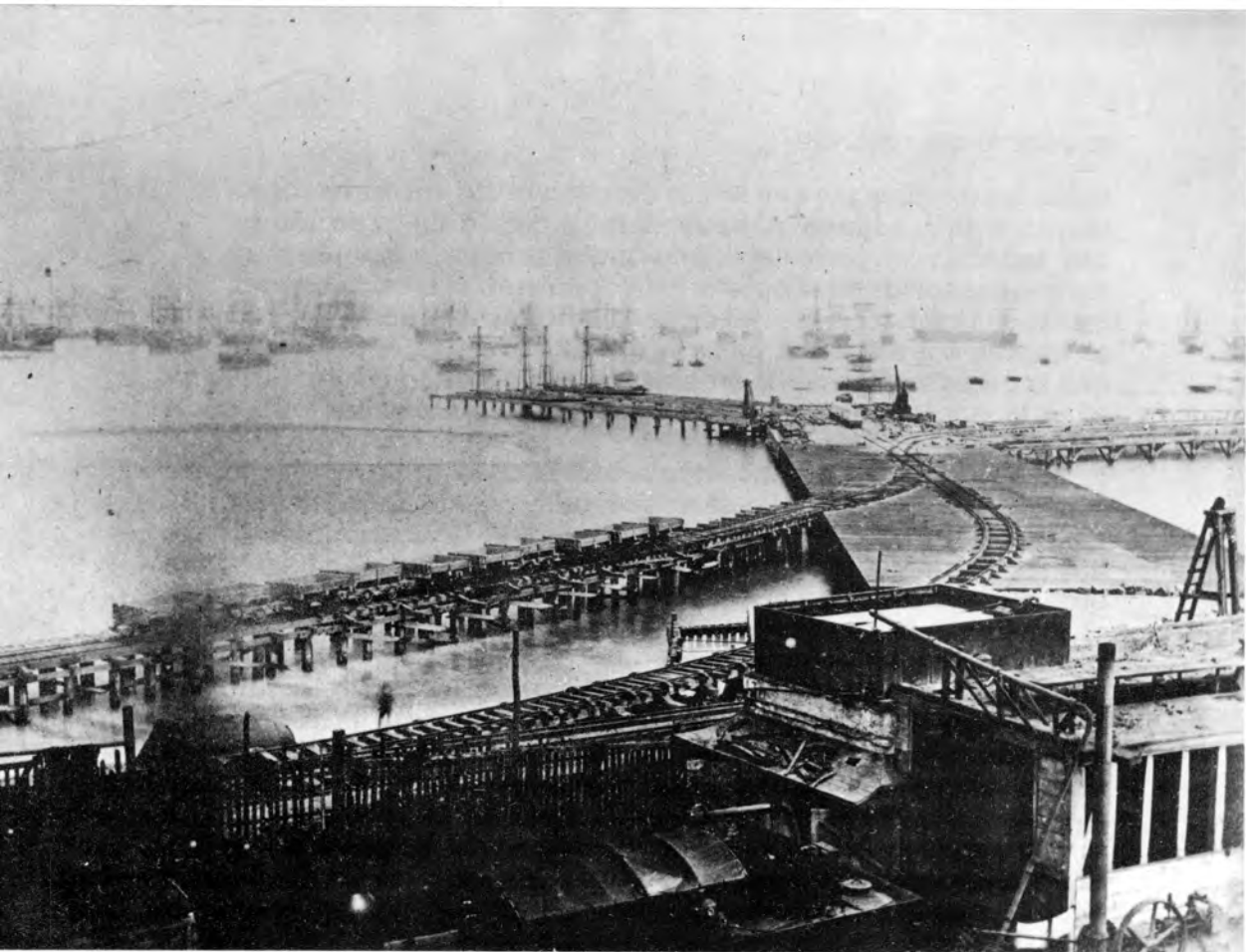
El muelle y dársena del Callao en su etapa de construcción en 1869. (Archivo Fotográfico ENAPU).
