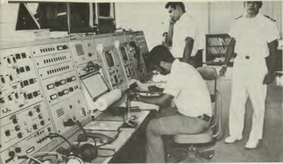
El C. de C. Oswald Gavidia frente a complicados tableros de mando en la Estación Terrena de Lurín...
