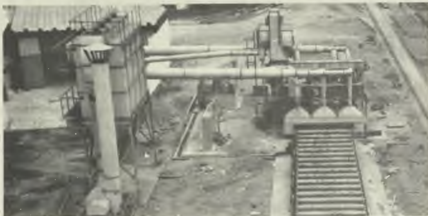
Transportador de rodillos para la habilitación de la máquina "Gramalladora". Este sistema fue construido en el SIMA.
