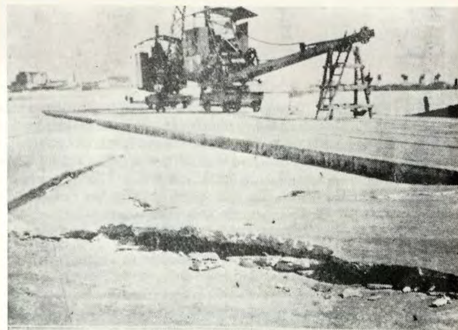
Resquebrajamiento sufridos en el piso del Terminal Marítimo.
